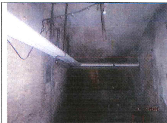
Tubazioni con rivestimento in cemento-amianto nelle cantine
