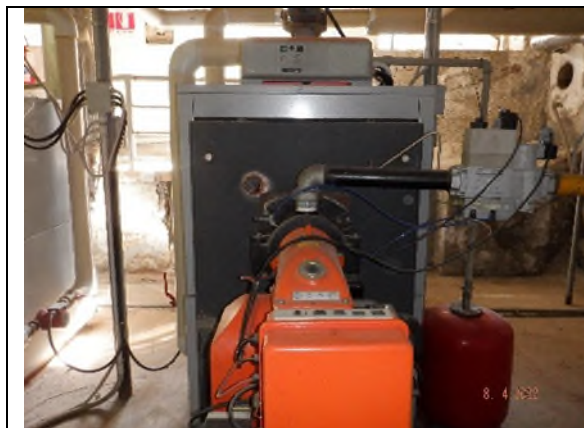
Nella centrale termica coibente delle caldaie in FAV
