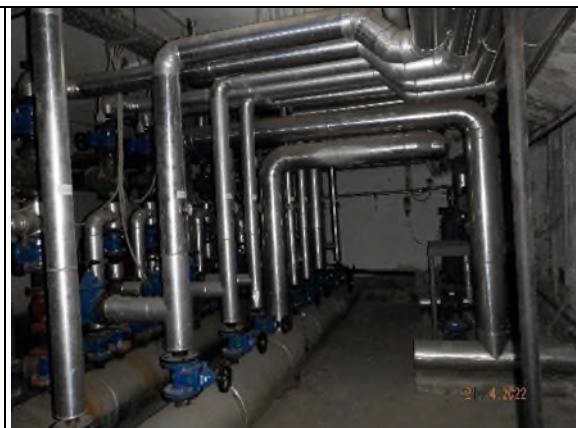
Nella centrale termica e nella sottocentrale coibente delle tubazioni in FAV
